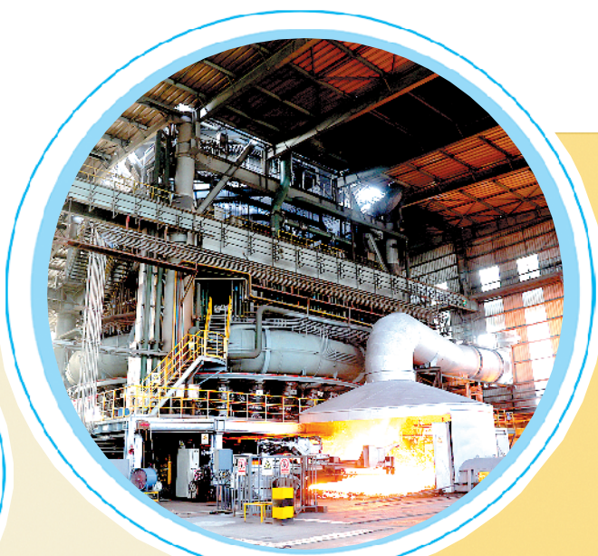
河南钢铁集团周口基地一号锅炉车间
