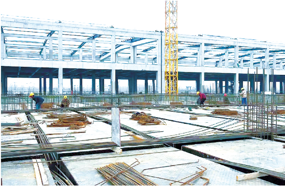
南通现代纺织科技(太康)产业园项目施工现场。记者 张洪涛 通讯员 张良 摄
